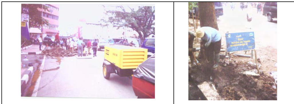
Gambar IV.9 Lokasi pipa bocor karena pengaruh pembebanan dinamik
