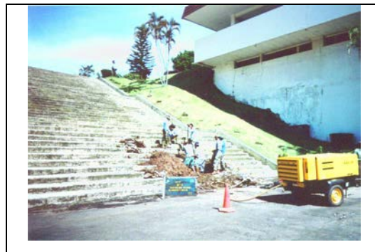
Gambar IV.10 Lokasi pipa bocor karena pengaruh pembebanan statik
