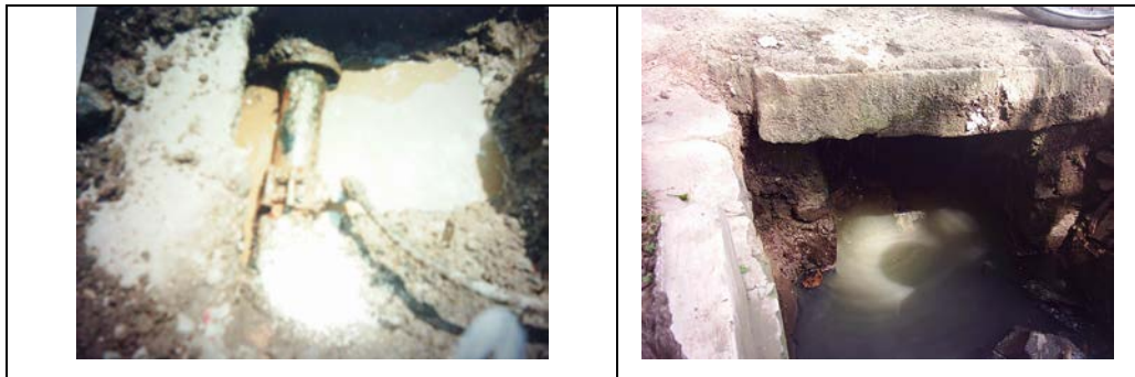
Gambar IV.13 Pipa rusak karena pengaruh kelembaban tanah/ udara
