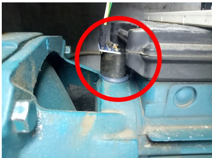
Gambar IV. 4 Posisi Pemasangan Akselerometer ADXL345 pada Mesin Pompa Rotari
