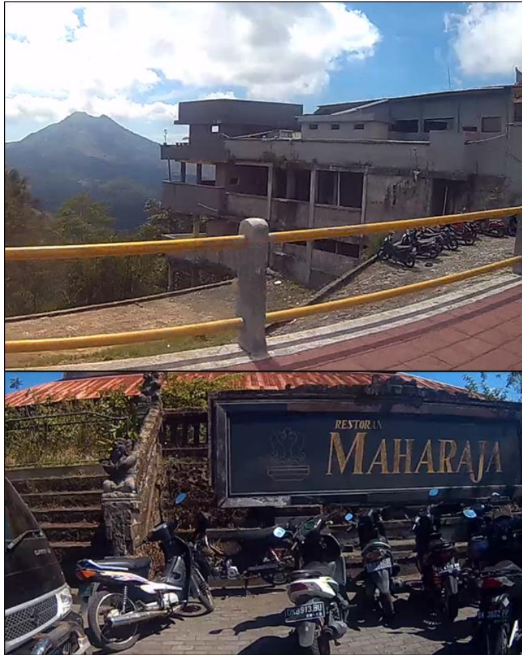
Gambar V.9 Pondasi restoran di sisi tebing dan restoran di sisi barat jalan yang sudah tidak beroperasi
