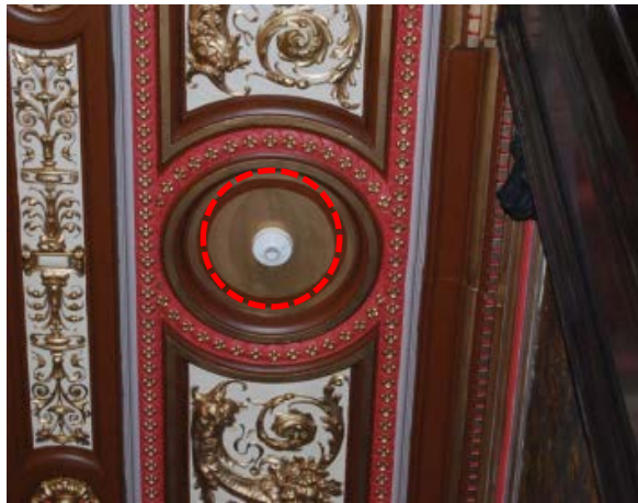
Gambar II.8 Detektor pada bangunan cagar budaya dengan langit-langit berpola Sumber: Coull, 2013
