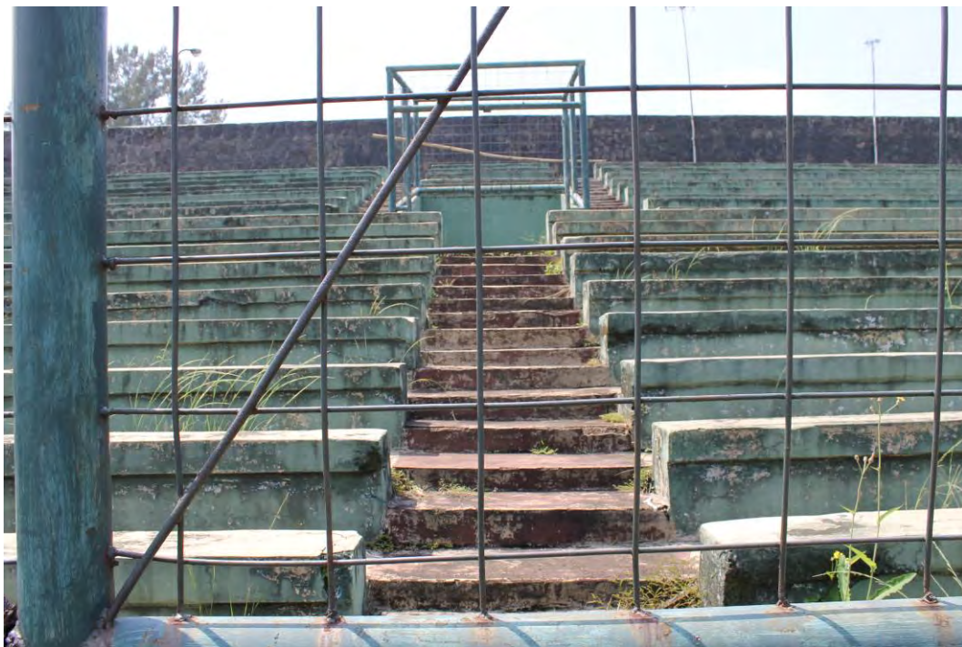
Gambar 3.11 Kondisi Tangga Tribun Timur Stadion Sepakbola Siliwangi-Bandung Sumber: Dokumentasi Pibadi
